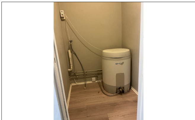
Bereder og opplegg for vaskemaskin i bod med waterguard
