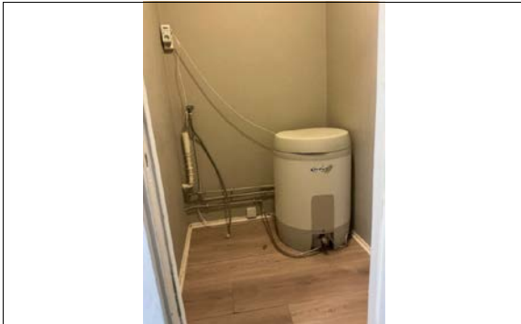
Bereder og opplegg for vaskemaskin i bod med waterguard
