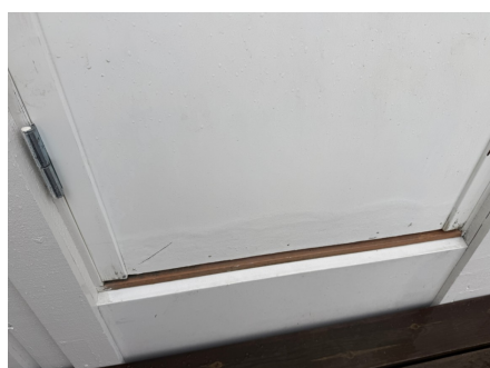
Fuktskader i nedre del på balkongdør
