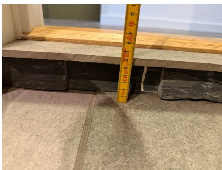
Oppkant ved dør på ca. 50mm.
