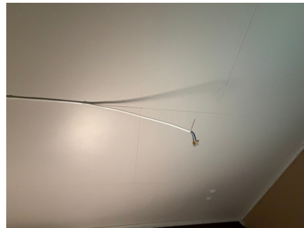
Løs kabler/punkt på soverom.
