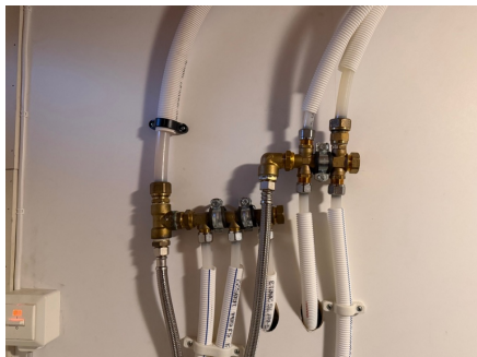
Det er ikke montert rør i rør skap.
