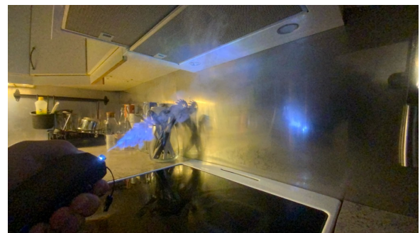
Funksjonstest av ventilator. Ok.
