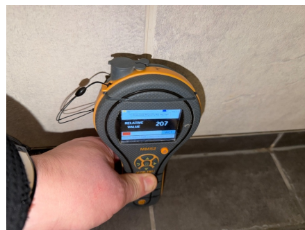
Utslag mot yttervegg
