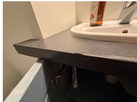
Fukt på benkeplate.
