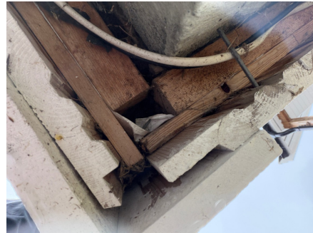
Det mangler musesperre i hjørnekassene.
