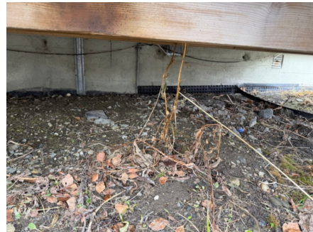
Grunnmursplast på deler av vegg mot nord, toppliste er løsnet.
