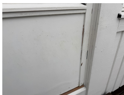
Fuktskader i nedre del på balkongdør
