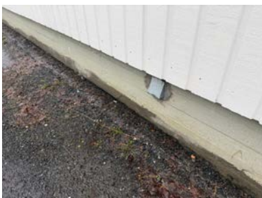
Ingen tegn til grunnmursplast mot vest.
