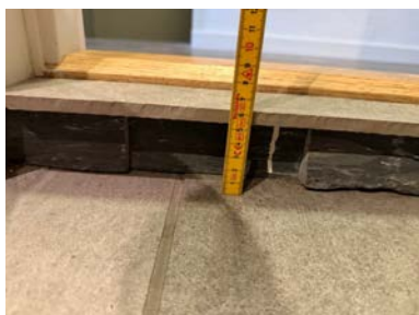
Oppkant ved dør på ca. 50mm.
