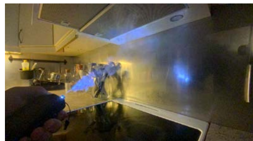
Funksjonstest av ventilator. Ok.
