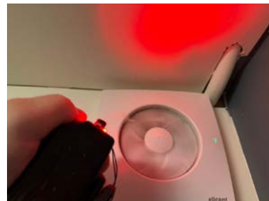
Fuksjonstest av avtrekk.
