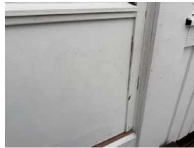
Fuktskader i nedre del på balkongdør
