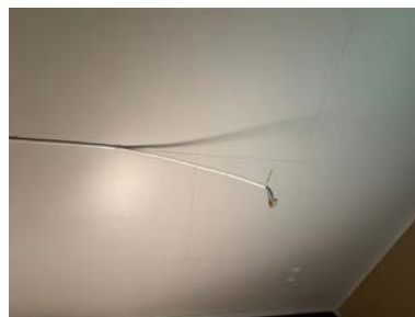
Løs kabler/punkt på soverom.
