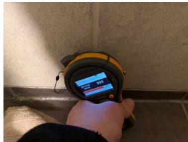
Fult utslag på fuktindikator på vegg mot bod.
