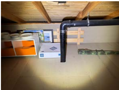
Soilrør før det går over i plast på kaldloft.
