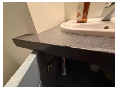
Fukt på benkeplate.
