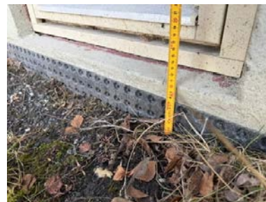
Kun en høyde på ca. 10cm opp til vindu. Mangler sålbenkbeslag og tetting rundt vindu.
