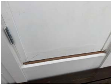
Fuktskader i nedre del på balkongdør
