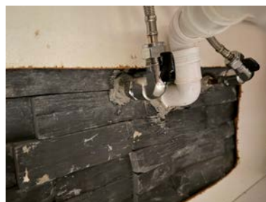
Ikke kjent om det er benyttet mansjetter rundt rørgjennomføringer.
