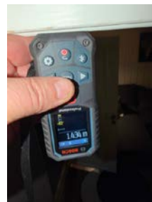
Meget lav frihøyde ved trapp til kjeller, kun 1,43m. Kravet er 2,00m.
