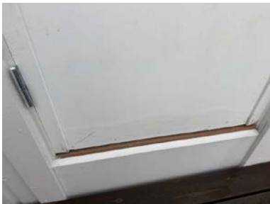
Fuktskader i nedre del på balkongdør
