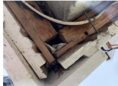
Det mangler musesperre i hjørnekassene.
