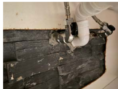
Ikke kjent om det er benyttet mansjetter rundt rørgjennomføringer.
