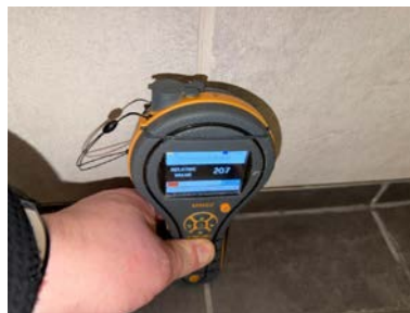
Utslag mot yttervegg
