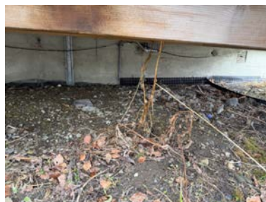
Grunnmursplast på deler av vegg mot nord, toppliste er løsnet.
