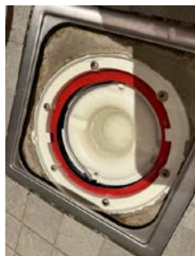
Synlig mansjett under klemring.
