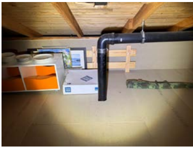
Soilrør før det går over i plast på kaldloft.
