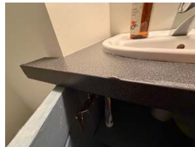
Fukt på benkeplate.
