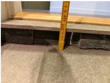
Oppkant ved dør på ca. 50mm.
