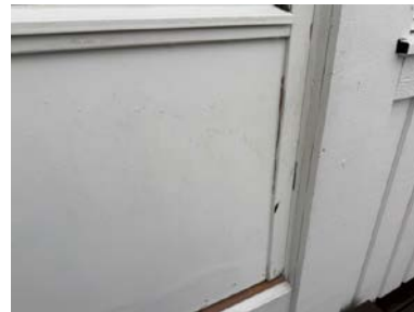
Fuktskader i nedre del på balkongdør
