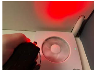
Fuksjonstest av avtrekk.
