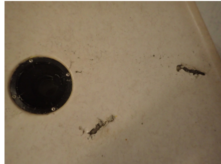
Skader i gulvbelegg.
