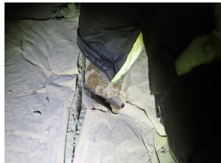
Kondens ifb. med ventilasjonsrør.
