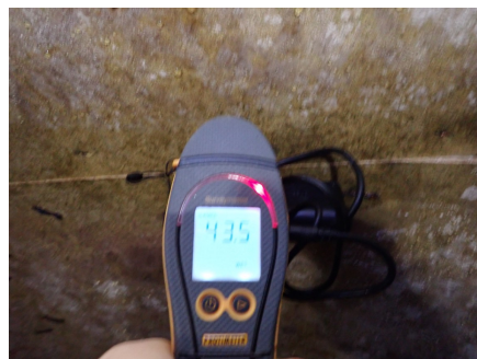
Det måles skadelig fukt i tiliggende konstruksjoner / etasjeskille.
