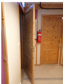
Slitasje i dører, dører i enkelte karmen mangler.
