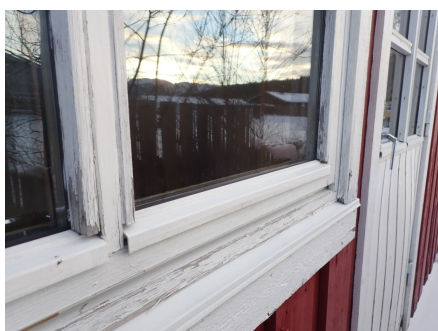
Vindu i dårlig tilstand.
