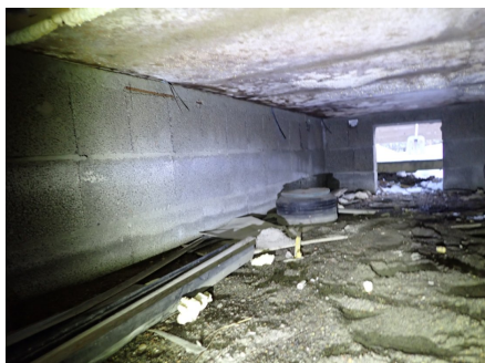
Fuktskader i krypkjeller
