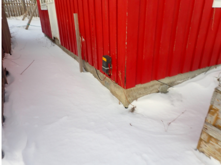
Råteskader i kledning / fasade
