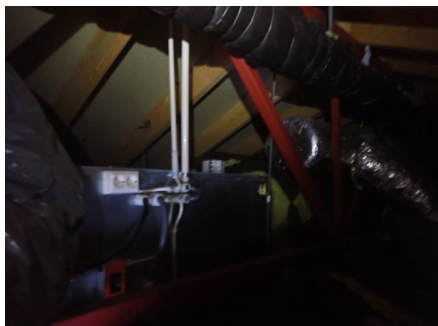
Ventilasjonsanlegg montert på kaldtloft.
