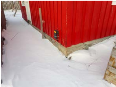
Råteskader i kledning / fasade
