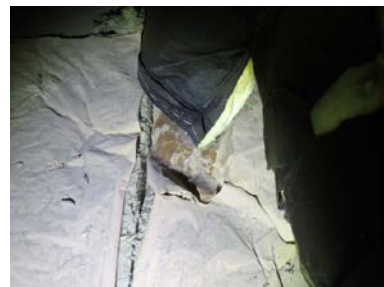
Kondens ifb. med ventilasjonsrør.
