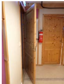
Slitasje i dører, dører i enkelte karmer mangler.
