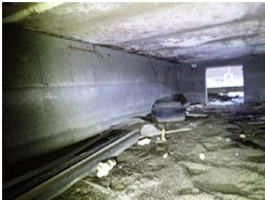
Fuktskader i krypkjeller
