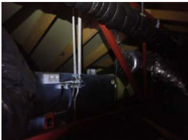
Ventilasjonsanlegg montert på kaldtloft.
