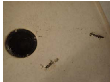
Skader i gulvbelegg.
