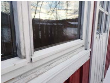
Vindu i dårlig tilstand.
