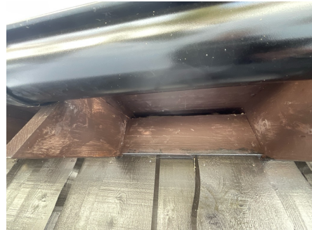
Ikke montert flueduk i luftespalter.
