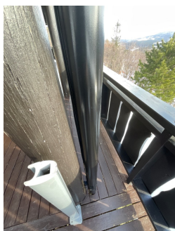
Enkelte frostsprengte taknedløp.
