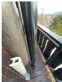
Enkelte frostsprengte taknedløp.
