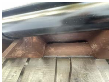
Ikke montert flueduk i luftespalter.
