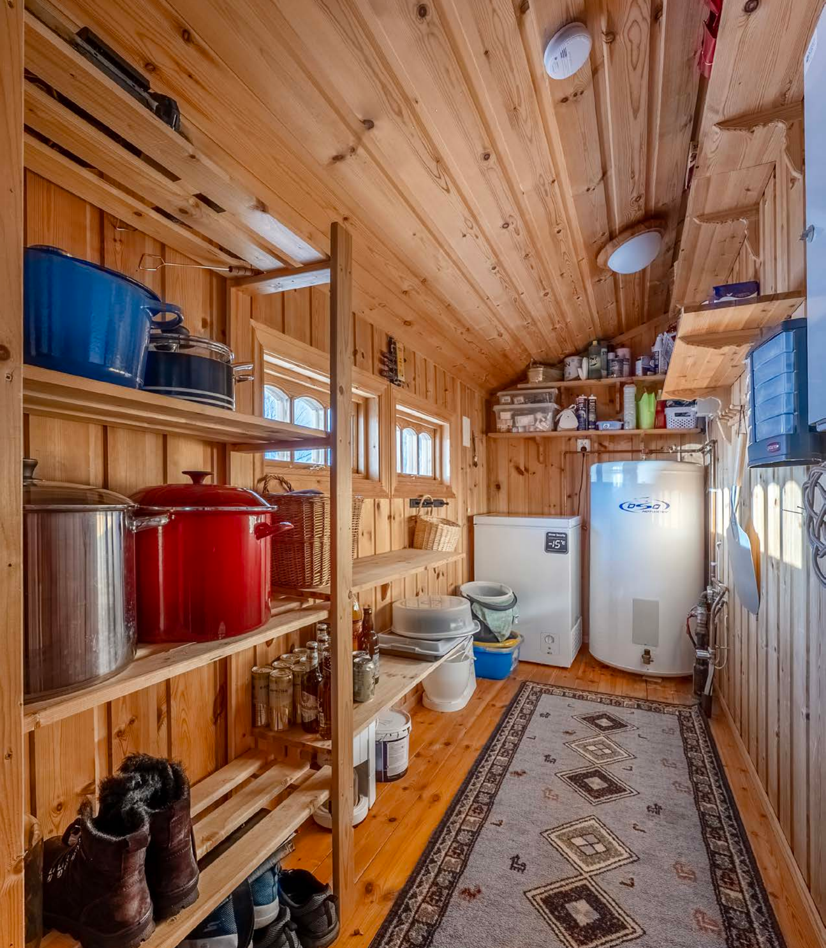
Bod/teknisk rom (1. etasje)
