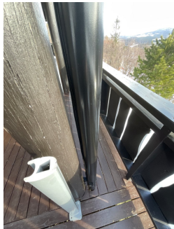
Enkelte frostsprengte taknedløp.
