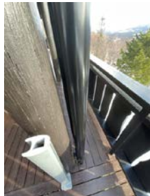
Enkelte frostsprengte taknedløp.
