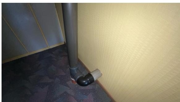
Del av rør til avløp.
