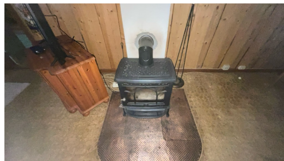
Montert ovn i stue - underetasjen.
