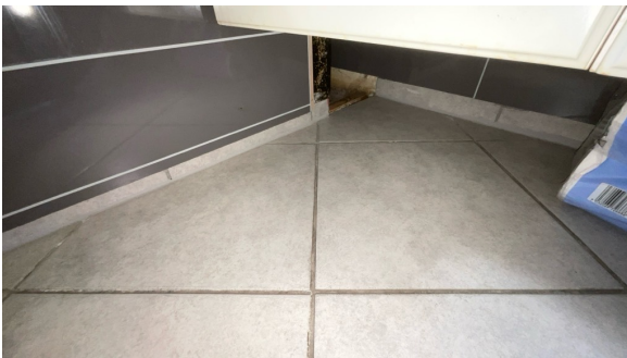
Sluk er ikke tilgjengelig for inspeksjon.
