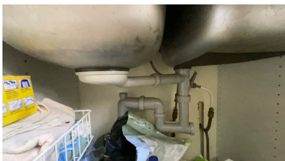
Del av rør til avløp.
