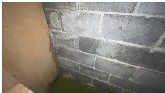
Del av rom under terreng. Symptomer på fukt, det er registrert fukt og saltutslag.
