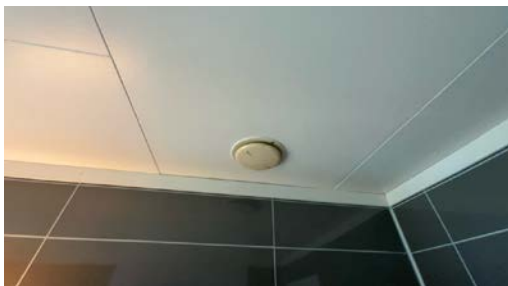
Montert ventil i tak.
