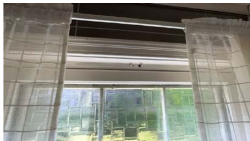
Ventil i vindu. Rommet har kun naturlig ventilasjon.
