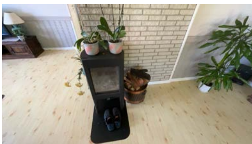
Montert ovn i stue.
