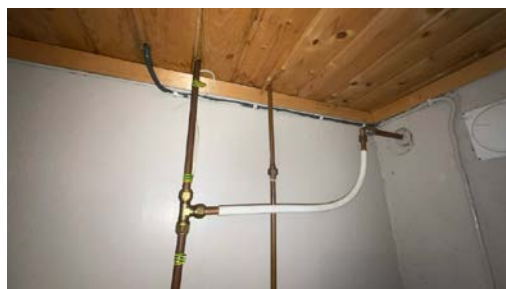
Del av rør til vann.
