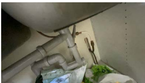
Del av rør til vann.
