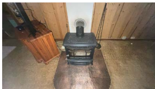
Montert ovn i stue - underetasjen.
