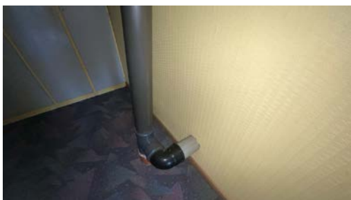
Del av rør til avløp.
