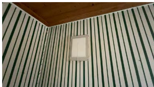
Eksempel på montert ventil i vegg.
