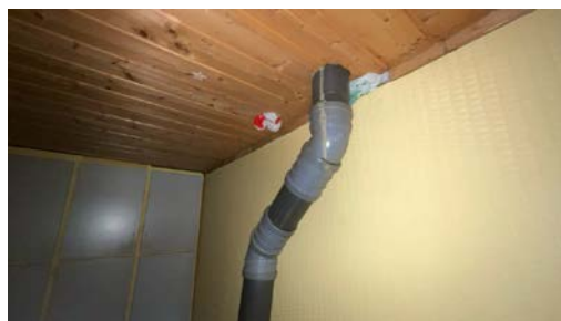
Del av rør til avløp.
