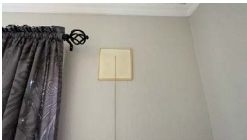
Eksempel på montert ventil i vegg.
