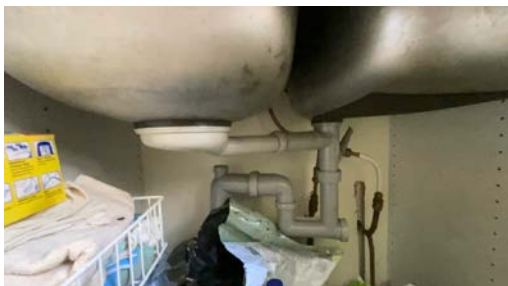
Del av rør til avløp.
