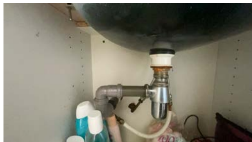
Del av rør til avløp.
