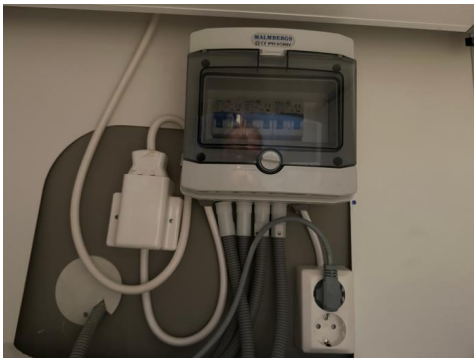
Sikringskap med automatsikringer plassert under platetopp på kjøkken.
