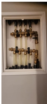
Samleskap med rørkurser og stoppekraner
