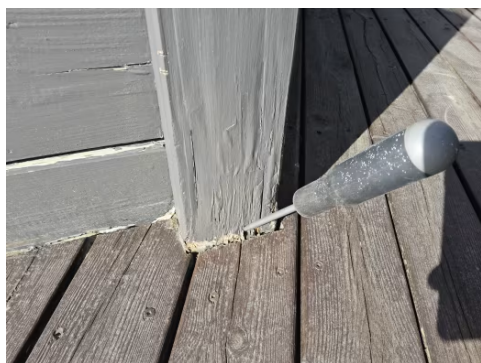
Råteskader i rekkverksstolpe.
