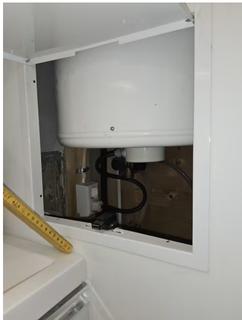
Vegghengt varmtvannsbereder plassert i kasse mellom toalettrom og bad.
