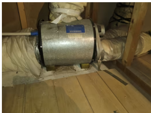
Mekanisk avtrekksvifte er plassert på kaldtloft.
