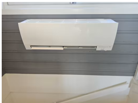
Varmepumpe plassert i trappegang.
