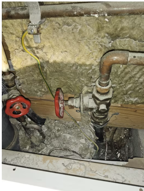
Hovedstoppekran er plassert i kasse mellom toalettrom og bad.
