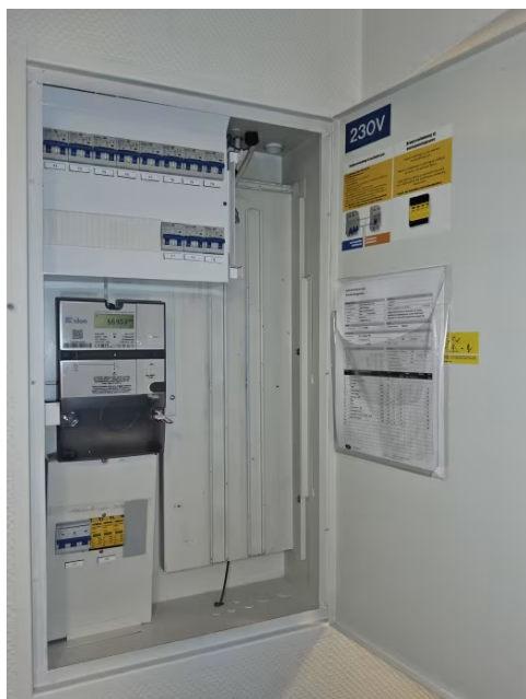
Sikringsskap med automatsikringer er plassert i gang.
