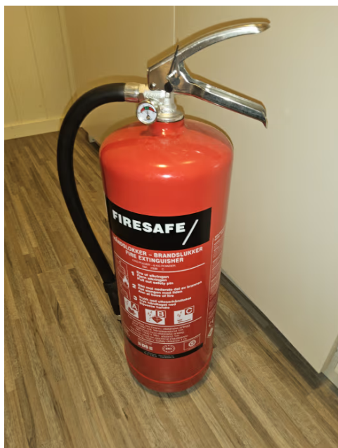
Boligen har godkjent brannslukningsapparat.
