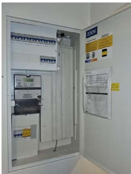
Sikringsskap med automatsikringer er plassert i gang.
