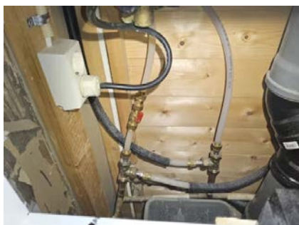
Rørkoblinger er plassert i kasse mellom toalettrom og bad.
