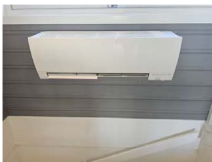
Varmepumpe plassert i trappegang.
