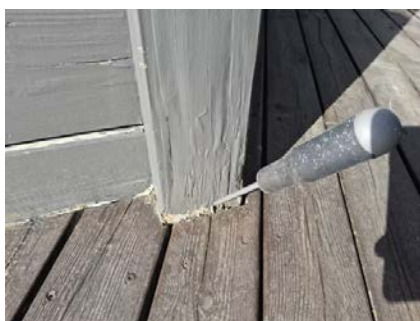
Råteskader i rekkverksstolpe.
