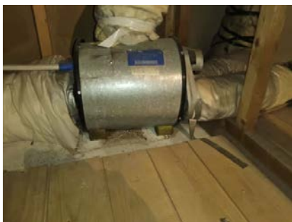
Mekanisk avtrekksvifte er plassert på kaldtloft.
