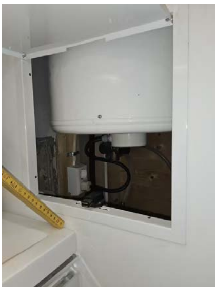
Vegghengt varmtvannsbereider plassert i kasse mellom toalettrom og bad.
