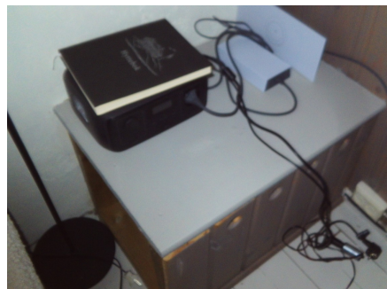
Batteribank i en kasse i stue.
