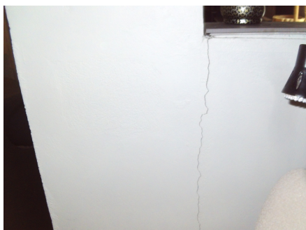
Sprekk i mellom pipe og brannmur.
