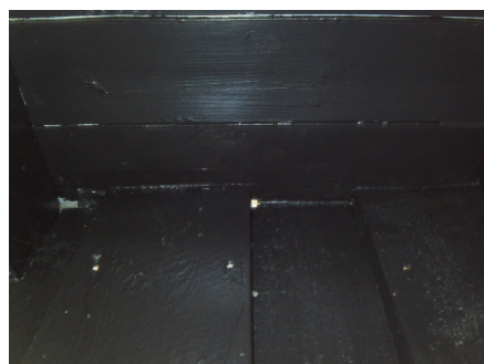
Ingen tilgang på luft ved takutstikk/gesims.
