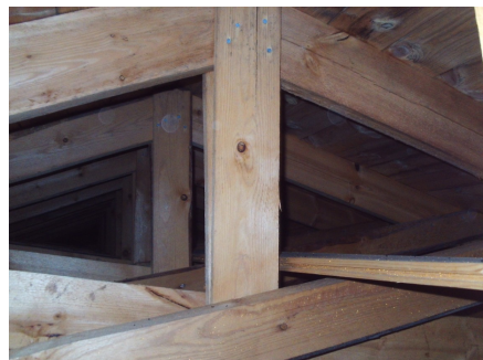
Deler av takkonstruksjon med noe mønet himling.
