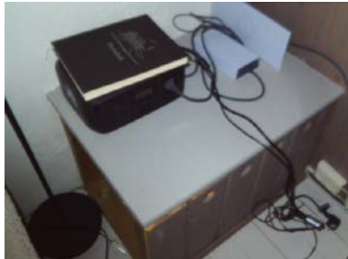
Batteribank i en kasse i stue.
