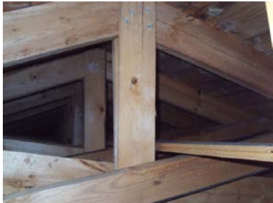
Deler av takkonstruksjon med noe mønet himling.
