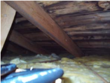
En god del blåved på undertaket enkelte steder
