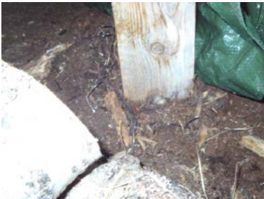
Ekstra enkle støtter som er satt opp i ettertid
