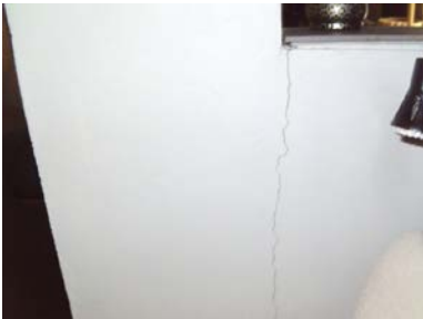
Sprekk i mellom pipe og brannmur.
