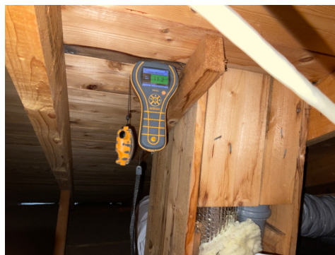
11,2 vektprosent fuktighet i fuktskjolde v/luftepipe
