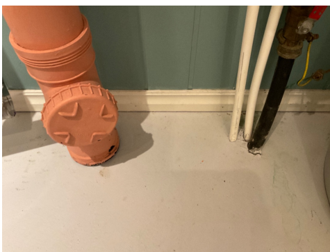
ann- og avløpsrør i teknisk rom
