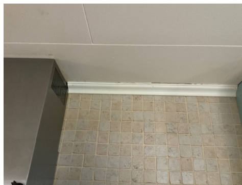
Malingsavflassing tak/list på kjøkken
