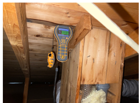
11,2 vektprosent fuktighet i fuktskjolde v/luftepipe
