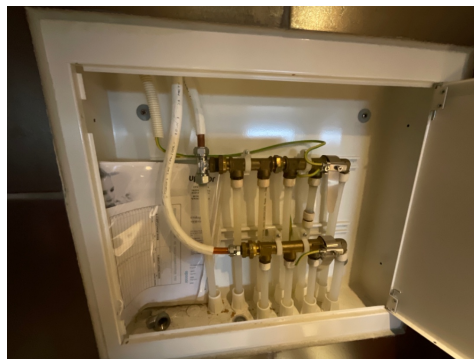
Rør i rør skap på vaskerom
