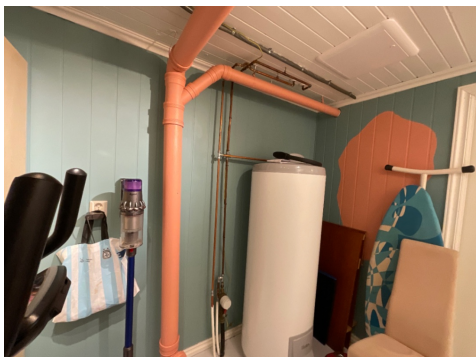
Innvendig vann, avløpsrør og bereder i kjelleren.
