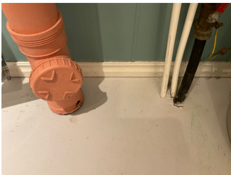
ann- og avløpsrør i teknisk rom
