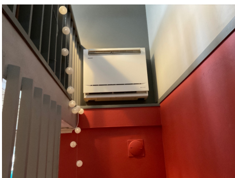
Varmepumpe i trapp
