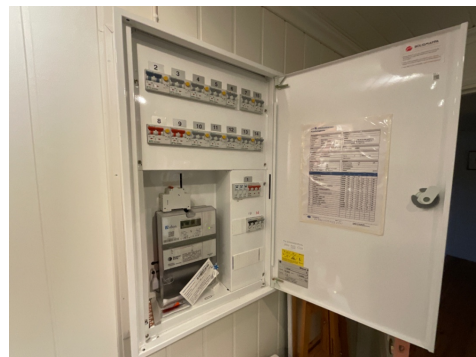
Sikringsskap i teknisk rom
