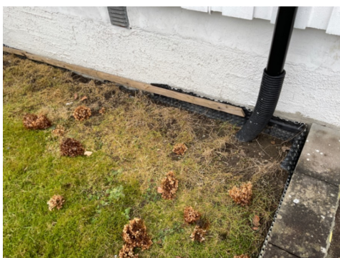
Synlig knotteplast bak huset ved kjellernedgangen
