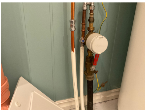
Stoppekran og vannmåler i kjelleren
