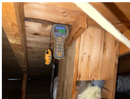
11,2 vektprosent fuktighet i fuktskjolde v/luftepipe
