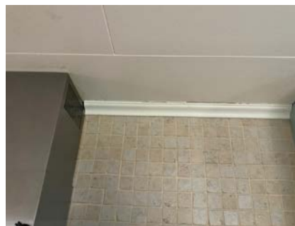
Malingsavflassing tak/list på kjøkken
