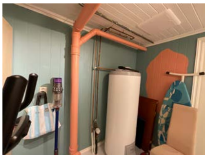
Innvendig vann, avløpsrør og bereder i kjelleren.
