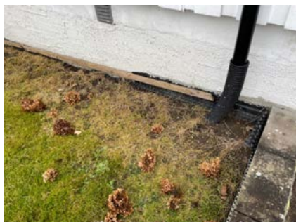
Synlig knotteplast bak huset ved kjellernedgangen
