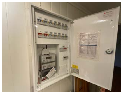
Sikringskap i teknisk rom
