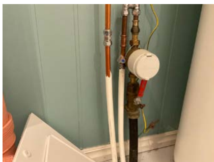
Stoppekran og vannmåler i kjelleren
