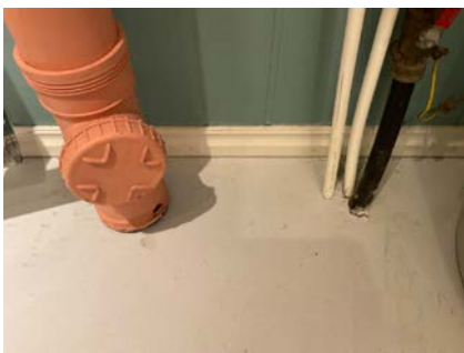
ann- og avløpsrør i teknisk rom
