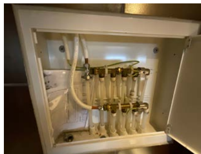
Rør i rør skap på vaskerom
