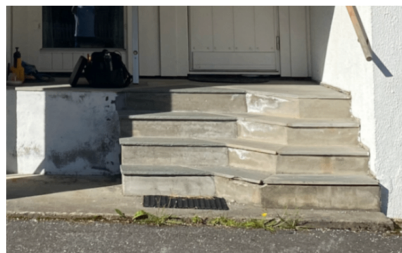
Betongtrapp med skiferstein.
