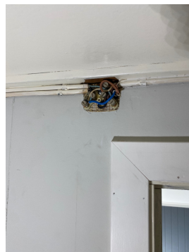
Eldre planlegg, mangler deksel.
