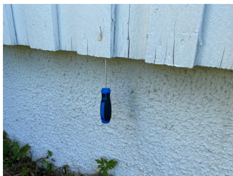
Stedvis påbegynt råteskader i nedkant kledning.
