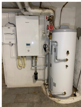
VVS bereder plassert på vaskerom i kjeller.
