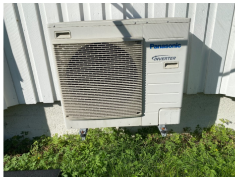
Varmepumpe utvendig del.
