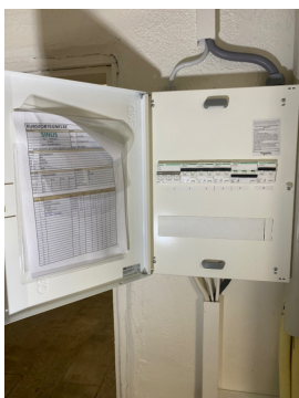
El-skap fra 2018, plassert på vaskerom i kjeller.
