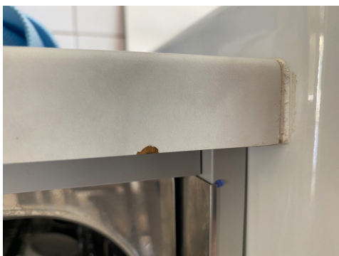
Skade i benkeplate.
