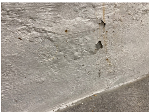
Saltutslag mot vegg/gulv.
