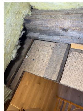
Manglende dampspærre i etasjeskillet mot kald sone.
