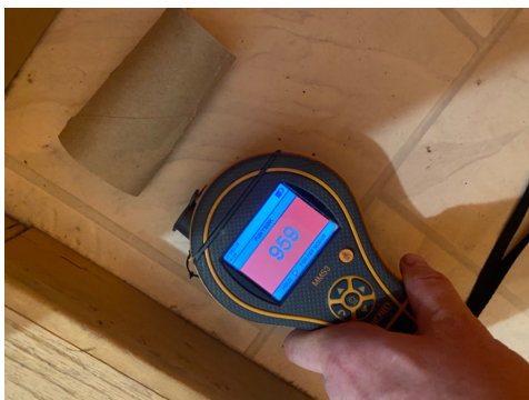
Forhøyde fuktverdier målt mot vinylbelegg.
