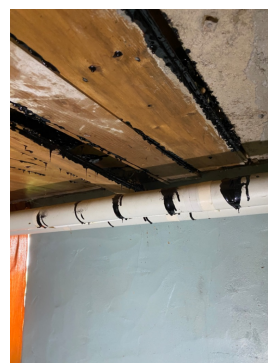
Skader i taket på bod mot øst.
