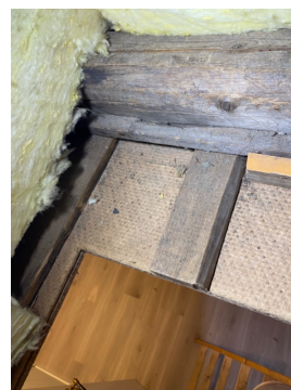
Manglende dampsperre i etasjeskillet mot kald sone.
