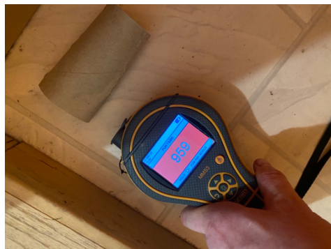
Forhøyde fuktverdier målt mot vinylbelegg.
