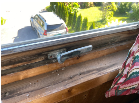
Vindu med råtskader.
