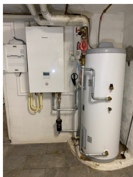
VVS bereder plassert på vaskerom i kjeller.
