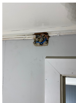
Eldre planlegg, mangler deksel.
