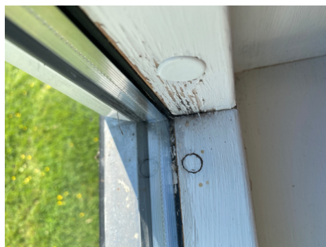
Vindu stue, tegn etter kondens.
