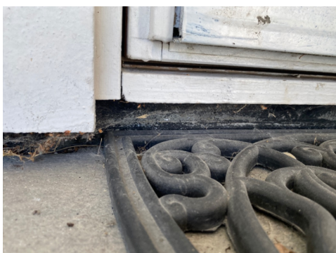
Døren mangler beslag i nedkant.
