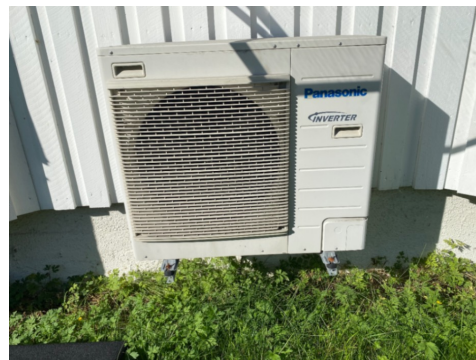
Varmepumpe utvendig del.
