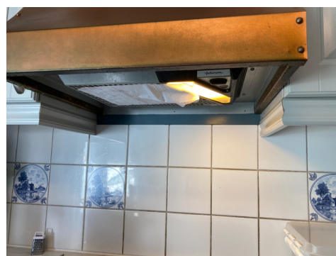
Funksjonstest av ventilator.
