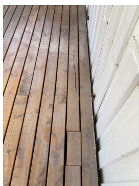
Normal slitasje utifra alder. Terrassebord mangler stedvis innfestning.
