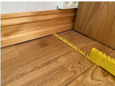
Stedvis glipper mellom gulv og gulvlist.
