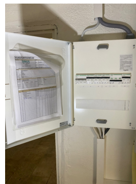
El-skap fra 2018, plassert på vaskerom i kjeller.
