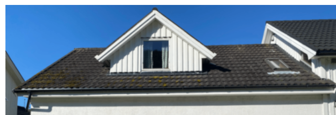
Stedvis mosegroing på taket mot sørøst.
