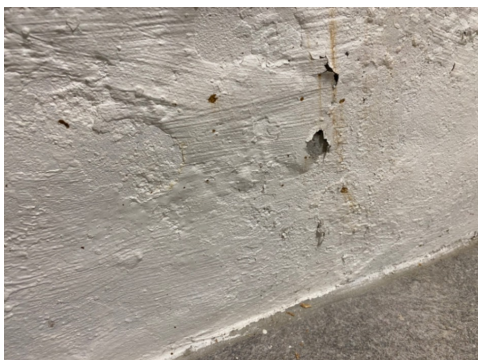
Saltutslag mot vegg/gulv.
