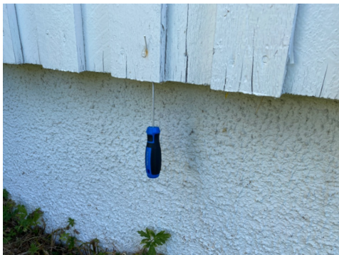
Stedvis påbegynt råteskader i nedkant kledning.
