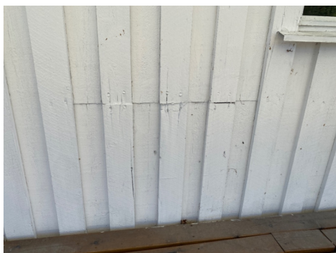
U-fagmessig utførelse av kledning.
