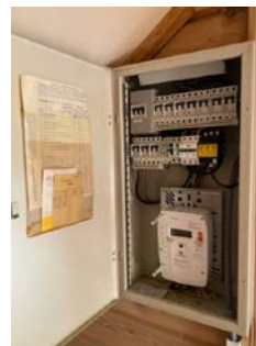
Sikringsskap med automatsikringer, plassert i loftetasjen
