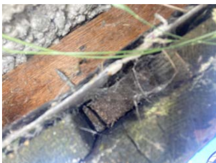
Begrenset lufting bak kledning.
