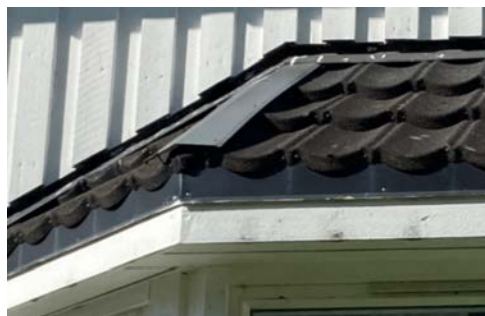
Dårlig innfestning av beslag, påvist stedvis rust i nedkant av beslag
