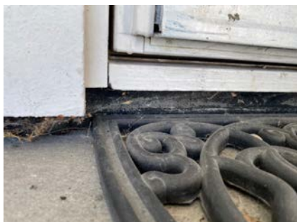
Døren mangler beslag i nedkant.
