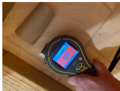
Forhøyde fuktverdier målt mot vinylbelegg.
