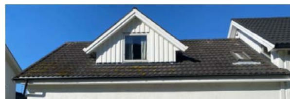
Stedvis mosegroing på taket mot sørøst.
