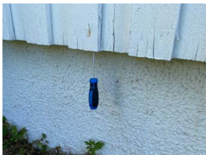
Stedvis påbegynt råteskader i nedkant kledning.
