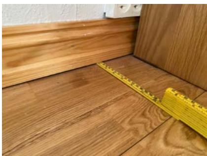
Stedvis glipper mellom gulv og gulvlist.
