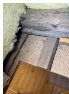
Manglende dampspærre i etasjeskillet mot kald sone.
