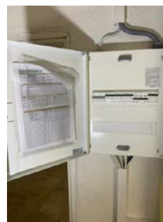
El-skap fra 2018, plassert på vaskerom i kjeller.
