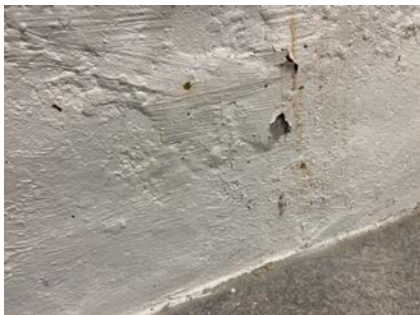
Saltutslag mot vegg/gulv.
