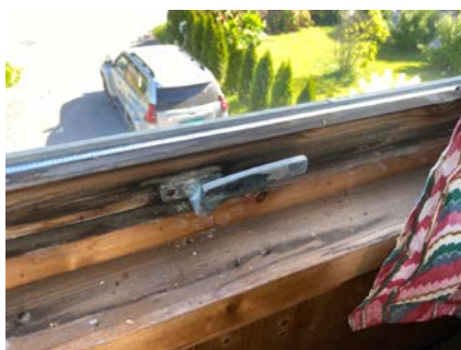
Vindu med råtskader.
