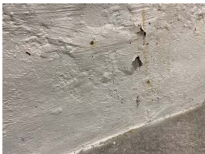
Saltutslag mot vegg/gulv.
