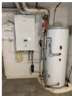
VVS bereder plassert på vaskerom i kjeller.
