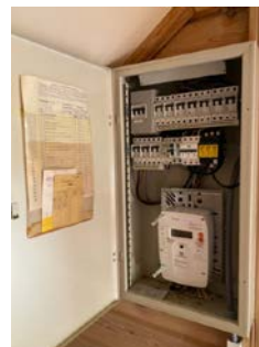
Sikringsskap med automatsikringer, plassert i loftetasjen
