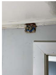
Eldre planlegg, mangler deksel.
