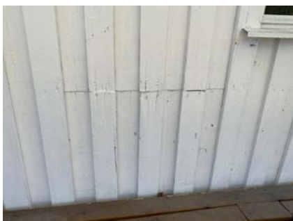
U-fagmessig utførelse av kledning.
