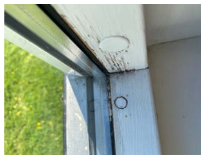
Vindu stue, tegn etter kondens.
