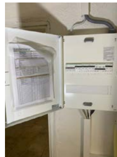
El-skap fra 2018, plassert på vaskerom i kjeller.
