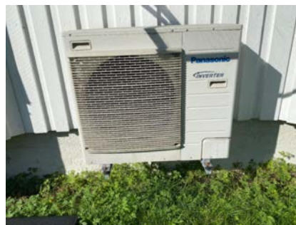
Varmepumpe utvendig del.
