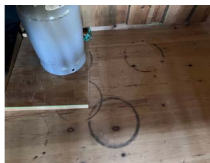
Skjolder i gulv etter gassflaske
