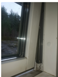
Nytt vindu på bad. Unøyaktig listing. 3 lags glass.
