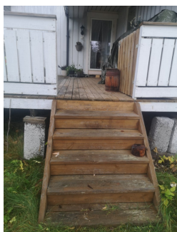
Terrassetrapp mangler rekkverk TG:3
