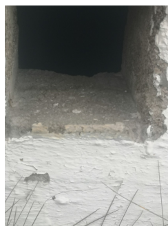
Åpen ventil. Skadedyr kan komme inn.
