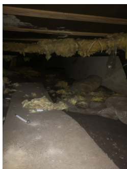
Skadedyr har vært på ferde å endret plast på grunn og rotet i isolasjon.
