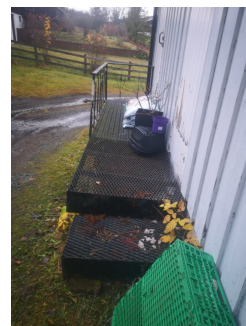
Smijernstrapp ved boder. Dårlig stand
