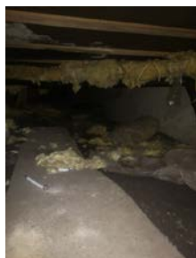
Skadedyr har vært på ferde å endret plast på grunn og rotet i isolasjon.
