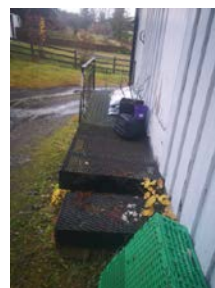
Smijernstrapp ved boder. Dårlig stand
