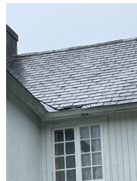
Eksempel på skade i takteking.
