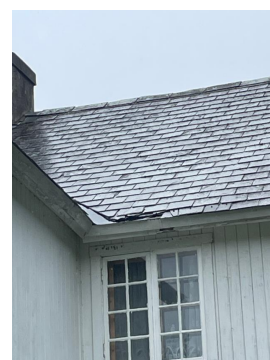
Manglende takrenner/kontrollert bortledning av takvann.
