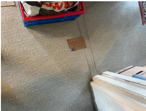
Eksempel på sår/skader i gulvbelegg.
