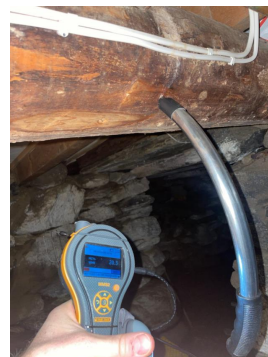
Det måles høye fuktverdier i trevirke.
