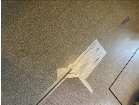
Eksempel på sår/skader i gulvbelegg.
