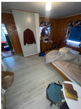
Eksempel på slitasje i overflatebehandling på gulv
