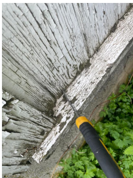
Råteskade i nedre del av ytterkledning.
