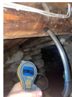
Det måles høye fuktverdier i trevirke.
