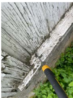
Råteskade i nedre del av ytterkledning.
