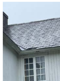
Eksempel på skade i taktekking.
