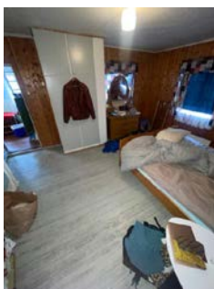
Eksempel på slitasje i overflatebehandling på gulv
