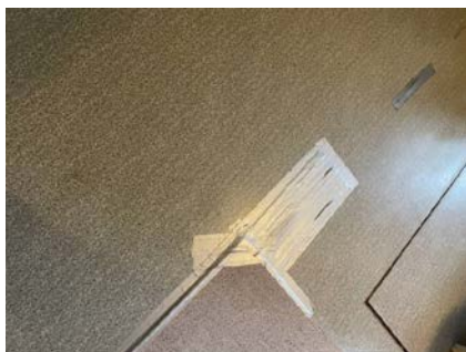
Eksempel på sår/skader i gulvbelegg.
