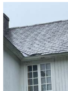
Manglende takrenner/kontrollert bortledning av takvann.
