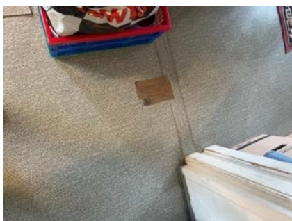
Eksempel på sår/skader i gulvbelegg.
