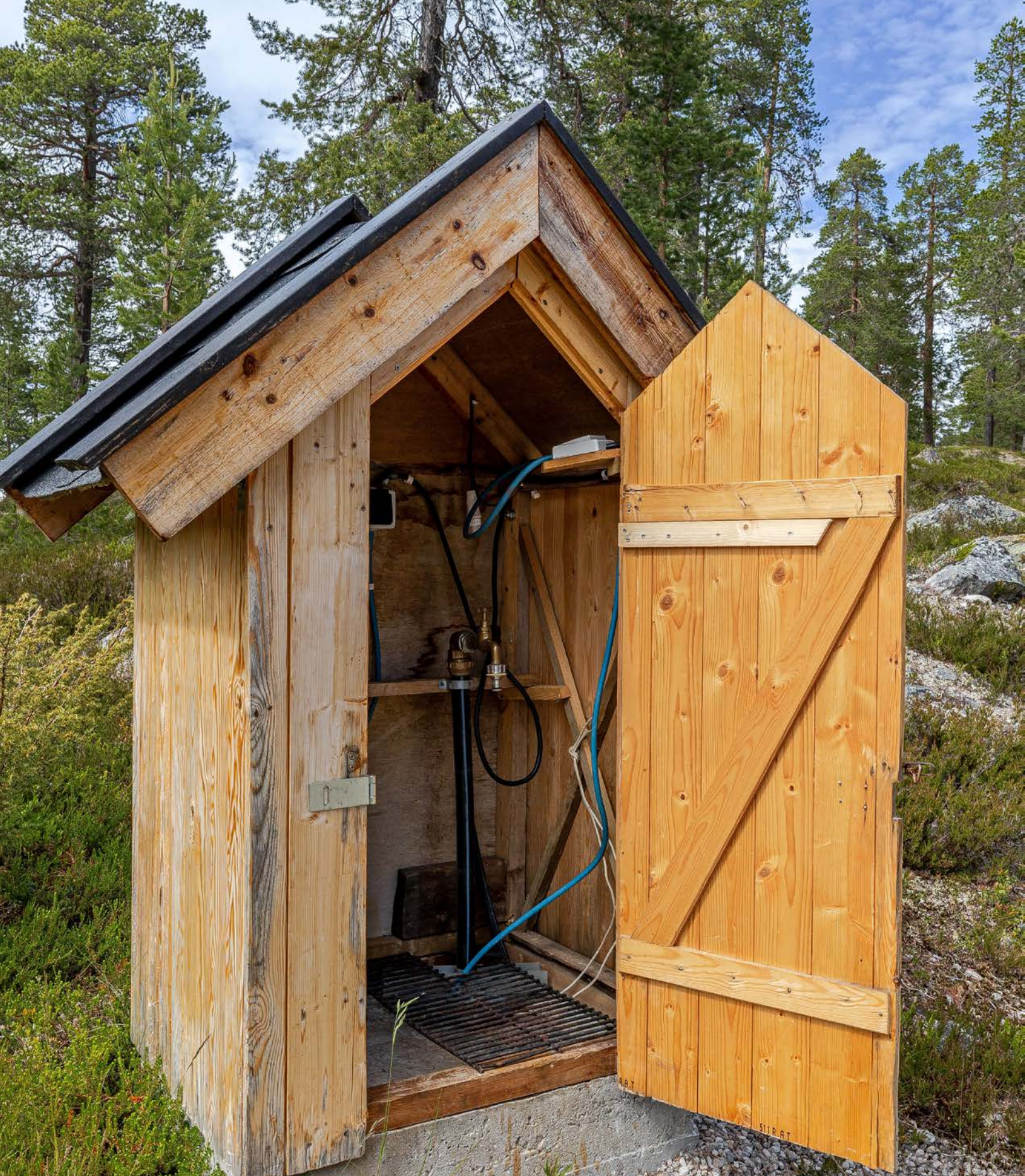
Brønnhus oppført på støpt plate på mark. Innlagt lys. Etablert vannpumpe og kran. Styring via bryter. Etablert sluk til grunnen. Vannkvalitet ukjent.
