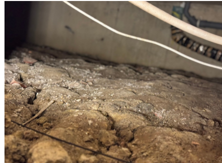
Mangler fuktsperre på grunnen
