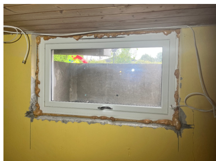
Uferdig innvendig rundt vinduer i kjeller.
