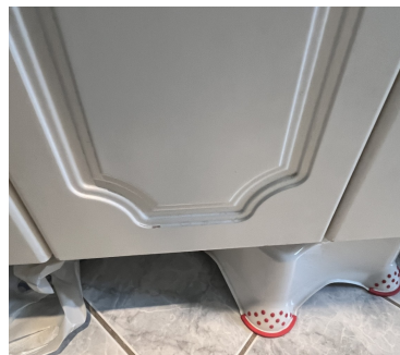
Noe slitasje merker på skapfronter.
