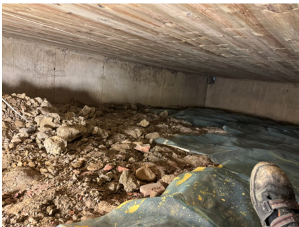
Mangler fuktsperre på grunnen
