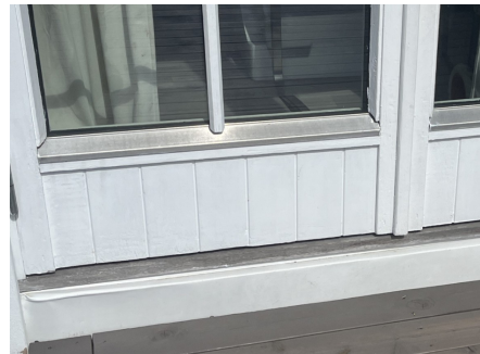
Dørbladet er noe fukt påvirket
