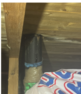
Eldre fuktmerker, årsak er kondesvann fra kloakklufteringen
