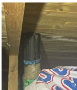
Eldre fuktmerker, årsak er kondesvann fra kloakkluftingen
