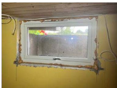
Uferdig innvendig rundt vinduer i kjeller.
