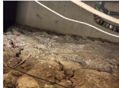
Mangler fuktsperre på grunnen
