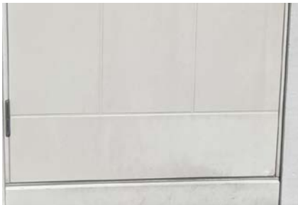
Skade i nedkant på dørblad
