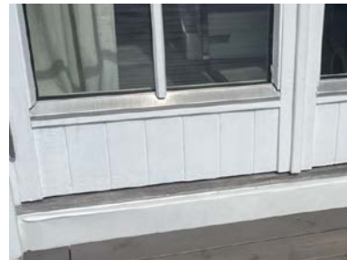
Dørbladet er noe fukt påvirket
