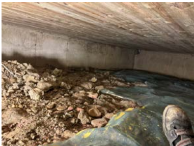
Mangler fuktsperre på grunnen
