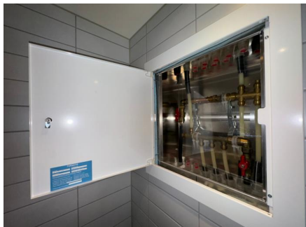
Vannfordelerskap på bad/wc
