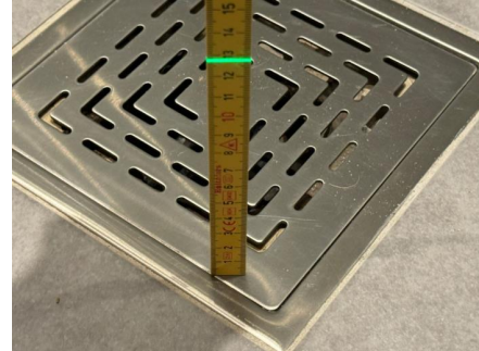
Fallforhold ca. 127 mm topp slukrist i dusjsone
