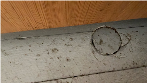
Tettet hull i kjøkkengulv
