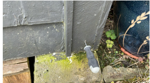
Råte i hjørnekasse
