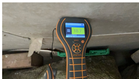
Øst - Forhøyede fuktverdier utover det som anses som akseptabelt.
