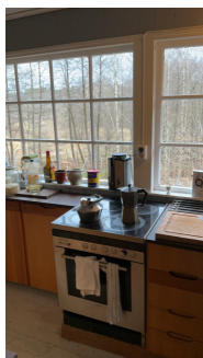
Mangler mekanisk avtrekk til kokesonen
