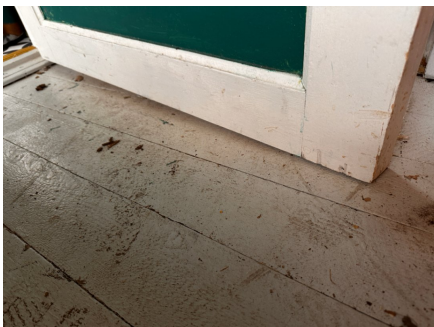
Badedøren tar i gulvet
