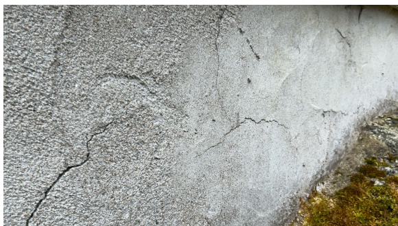
Noe ris/sprekker og skjevherter i mur mot nord
