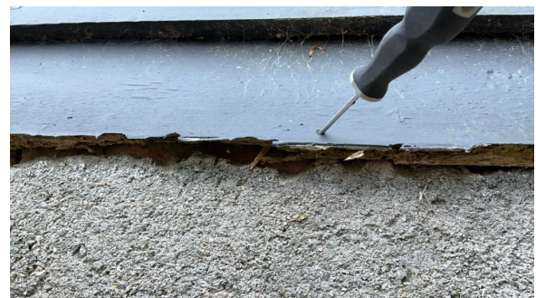
Råte i kledning
