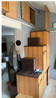
Mangler rekkverk og håndløper i trapp.
