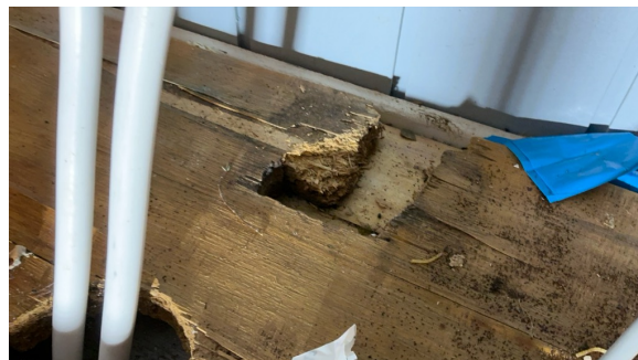
Gamle fuktskader i skap
