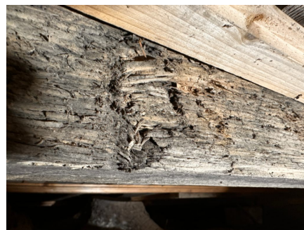
Midten - Det er registrert betydelige nedbrytningsskader i gulvbjelke i krypkjeller.
