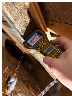
Midten - Høy fuktighet i gulvbjelke
