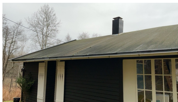
Mangler stigetrinn og snøfanger
