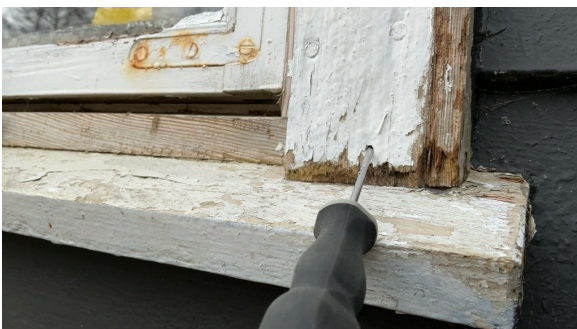
Råte i belistning
