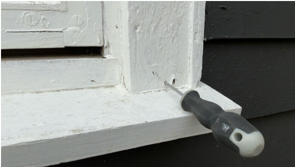
Råte i belistning
