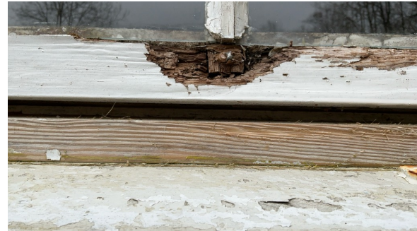
Råte i stuevindu
