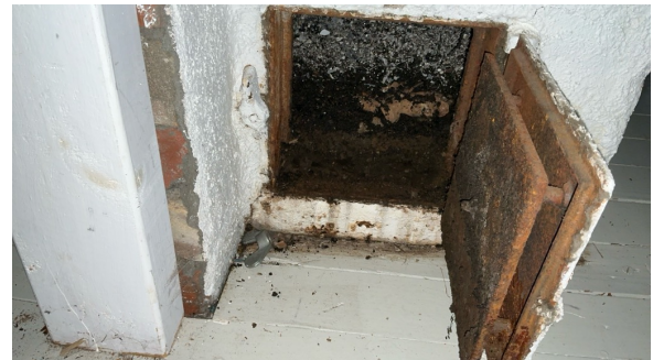
Manglende gulvplate, samt brennbart materiale nærmere en 300 mm fra feieluke.
