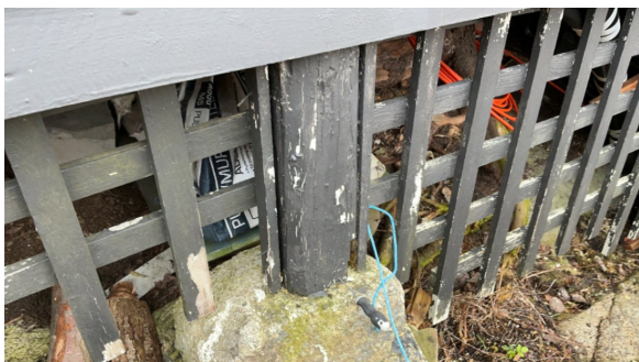
Råte i bunn av søyle mot øst
