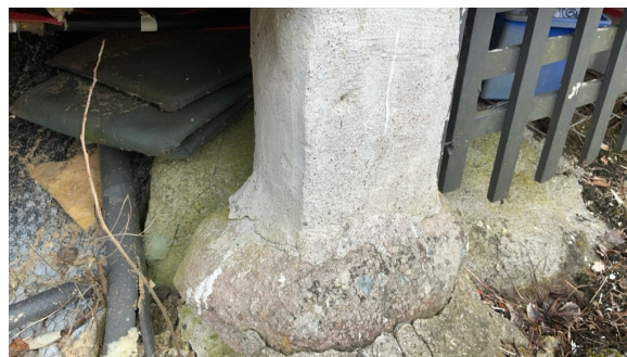
Riss i bunn av søylepunkt
