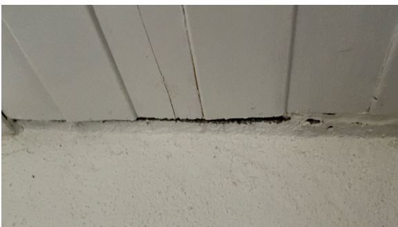
Mangler taklist ved pipe
