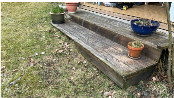
Litt skjevheter i trappen
