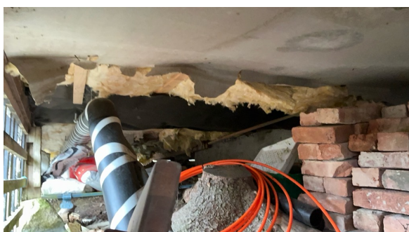
Øst - Isolasjon som ikke er tildekket og henger ned.
