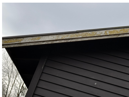
Vindskiver med behov for vask og vedlikehold.
