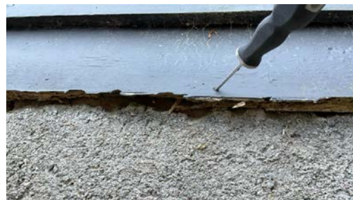
Råte i kledning
