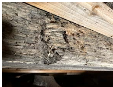
Midten - Det er registrert betydelige nedbrytningsskader i gulvbjelke i krypkjeller.
