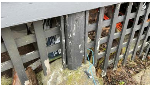
Råte i bunn av søyle mot øst
