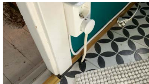
Varmtvannsbereder er tilkoblet via stikkontakt på badet.
