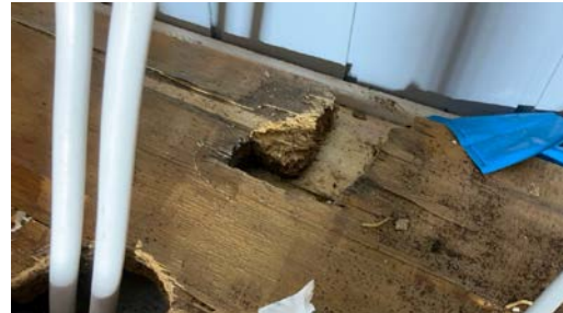
Gamle fuktskader i skap
