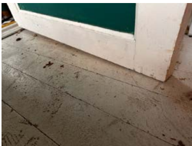
Badedøren tar i gulvet
