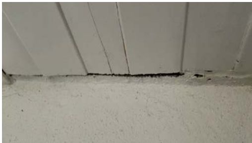
Mangler taklist ved pipe
