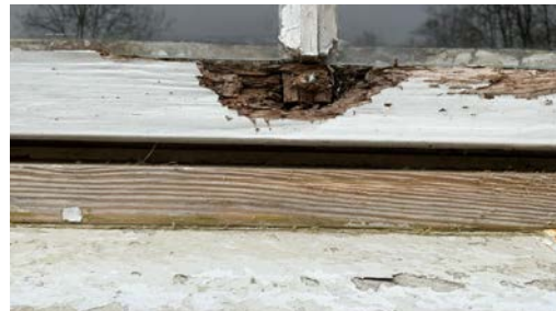
Råte i stuevindu
