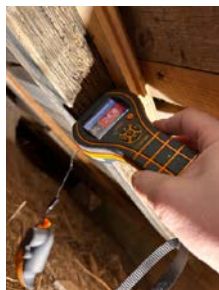
Midten - Høy fuktighet i gulvbjelke
