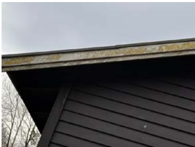
Vindskiver med behov for vask og vedlikehold.
