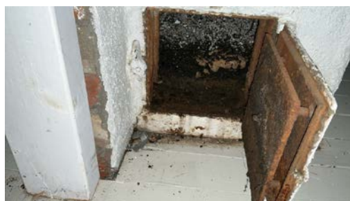
Manglende gulvplate, samt brennbar materiale nærmere en 300 mm fra feieluke.
