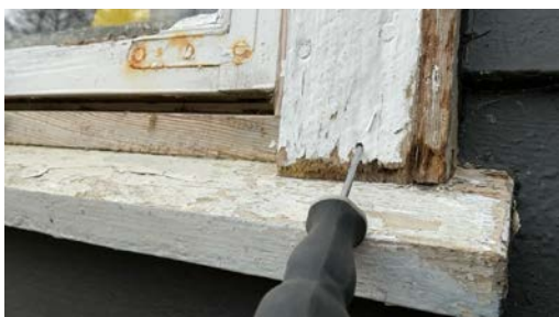
Råte i belistning
