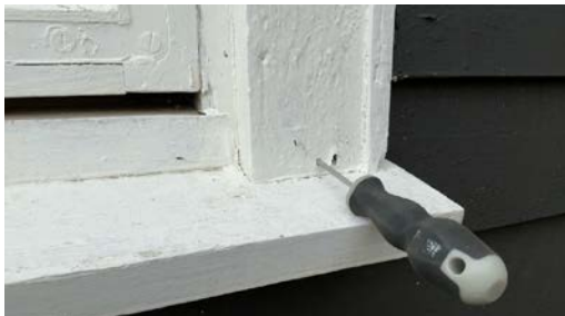
Råte i belistning
