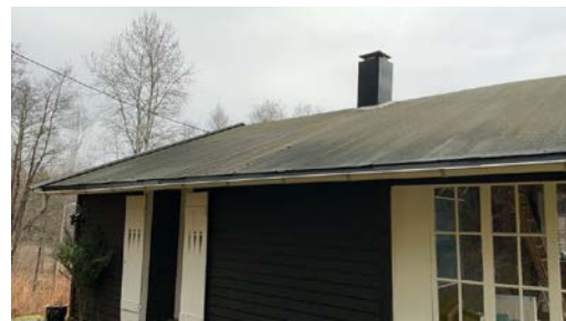
Mangler stigetrinn og snøfanger
