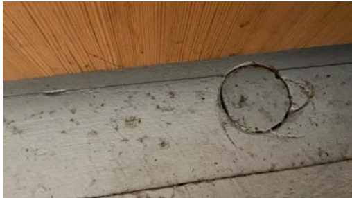
Tettet hull i kjøkkengulv
