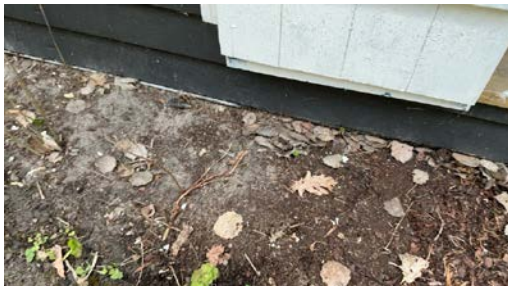
Kledning med liten klaring til terreng.
