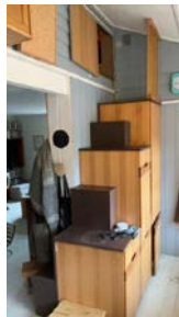
Mangler rekkverk og håndløper i trapp.
