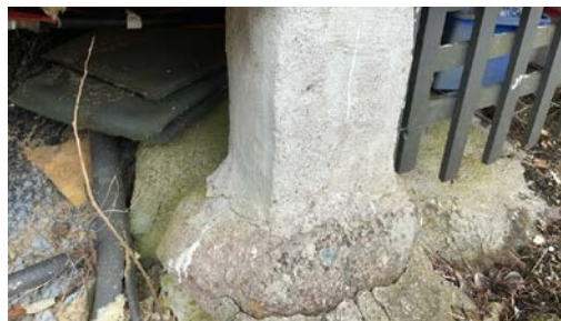
Riss i bunn av søylepunkt
