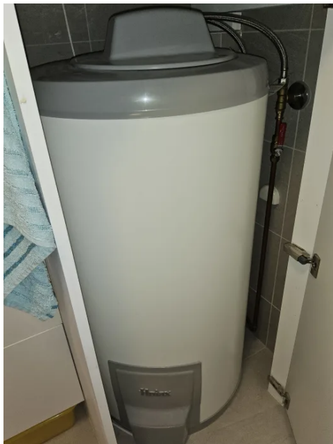
Bilde viser varmtvannsbereder.
