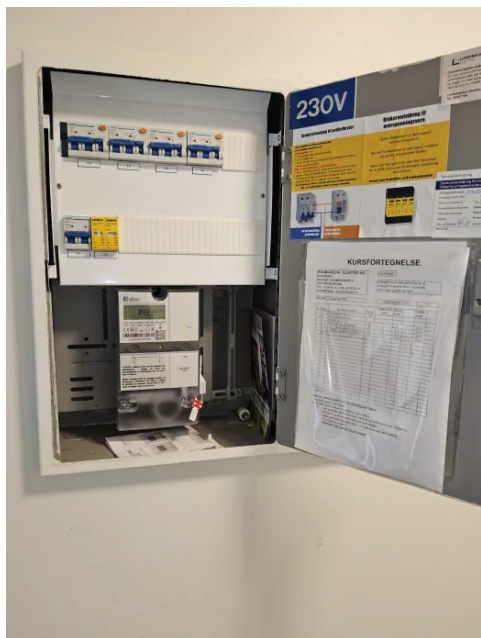
Bilde viser sikringsskap.
