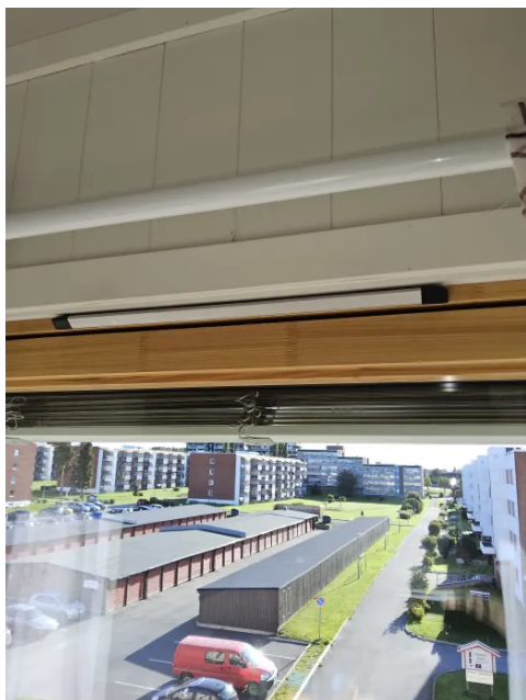
Bilde viser spalteventil i vindu.
