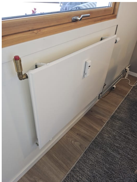
Bilde viser radiator.
