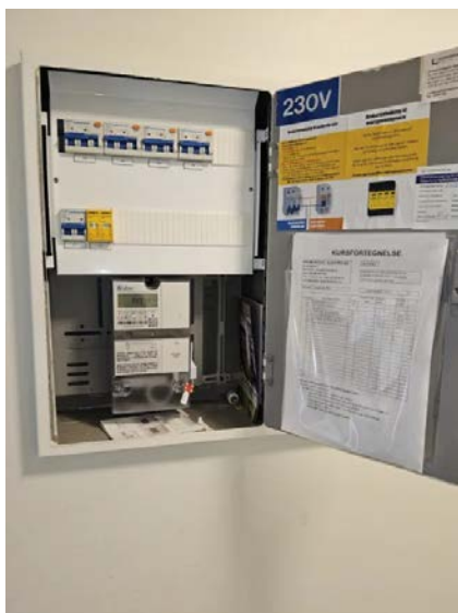
Bilde viser sikringsskap.
