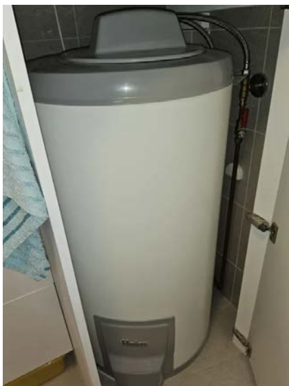
Bilde viser varmtvannsbereider.
