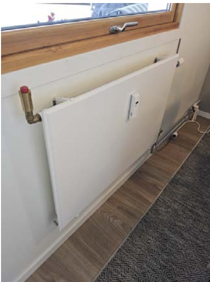
Bilde viser radiator.
