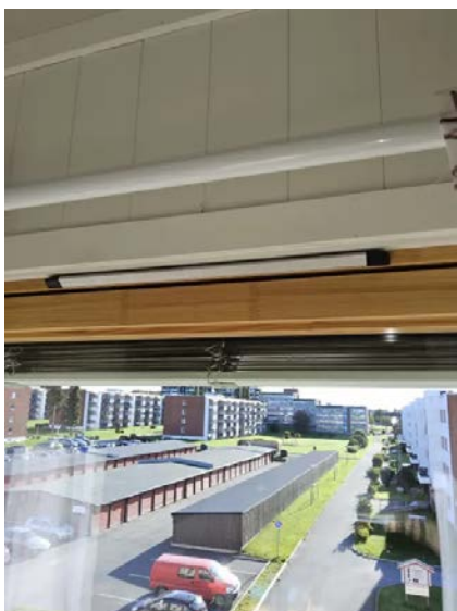
Bilde viser spalteventil i vindu.
