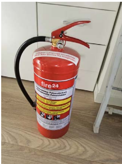
Bilde viser brannslukningsapparat.
