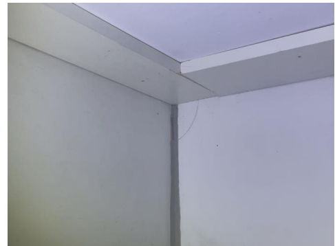
Liten sprekk i flis
