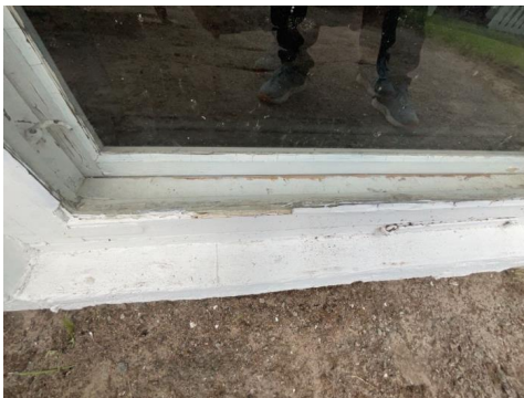
Løst kitt kjellervinduer
