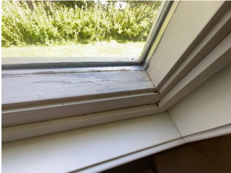
Slitasje i karm eldre isolerglass
