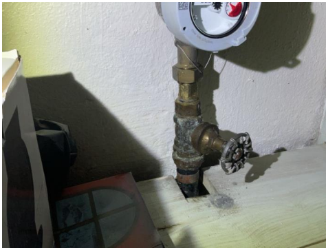
Fukt ved vanninntak
