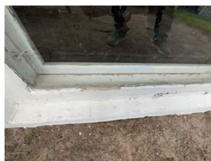
Løst kitt kjellervinduer
