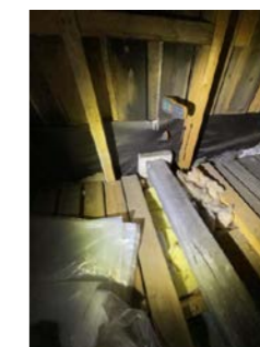
Sprekk i luftekanal synes nederst til høyre
