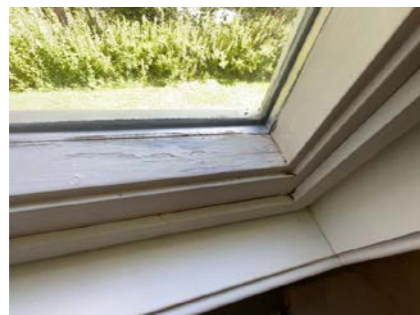
Slitasje i karm eldre isolerglass
