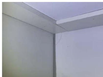
Liten sprekk i flis
