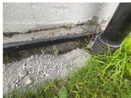
Topplst/original gudrong og "nyere" plast-fuktsperre som er glidd noe ned.
