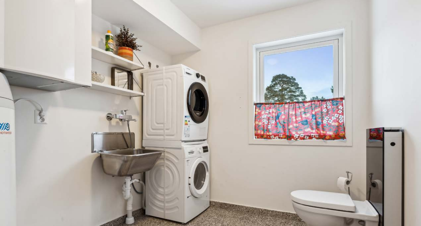
Vaskerom med skyllekar, opplegg for vaskesøyle og ekstra wc Rommet huser også det meste av boligens tekniske utstyr
