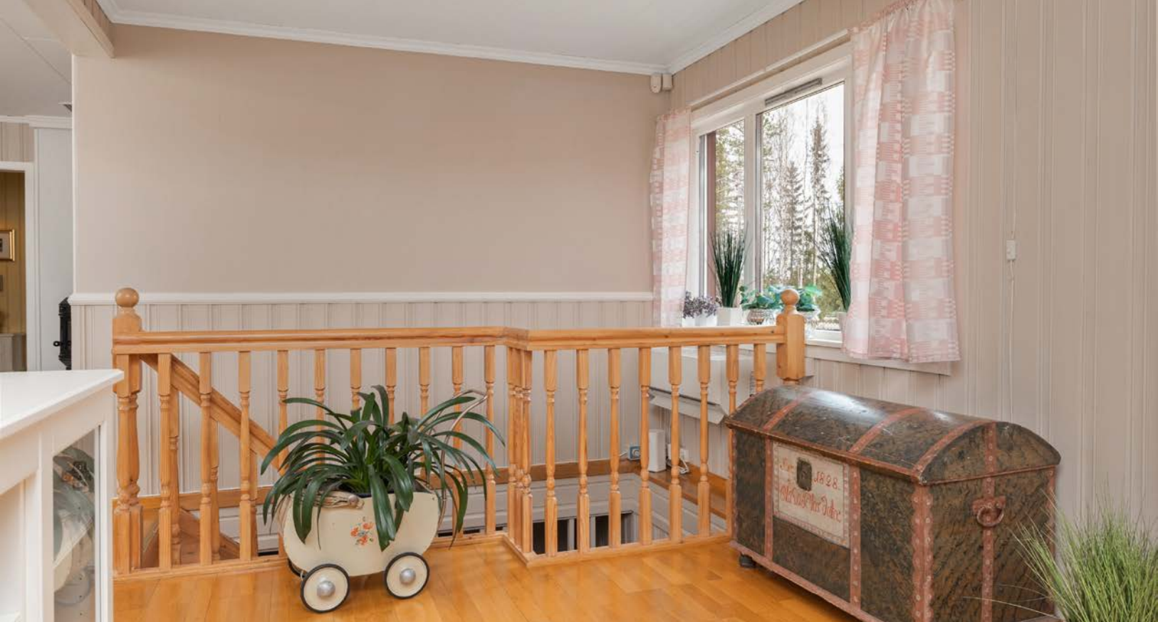
Boligen har 2 stk. varmepumper fra 2019 og 2008. Den ene er montert i stuen og den andre i trappen.
