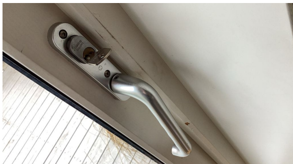
Enkelte merker på terrasse dør.
