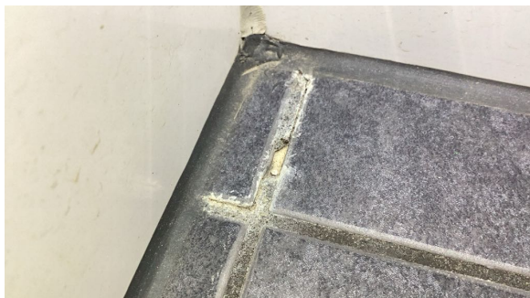
Mangler del av flisfuge.
