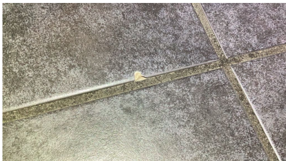
Avskalling på flis.
