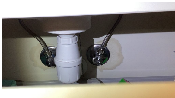
Misfarging på bakplate i servantskap.
