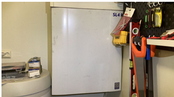
Ventilasjonsenhet på teknisk rom/bod.
