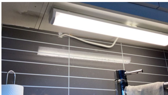
Ledning til lampe oppunder kjøkkenskap bør festes bedre.
