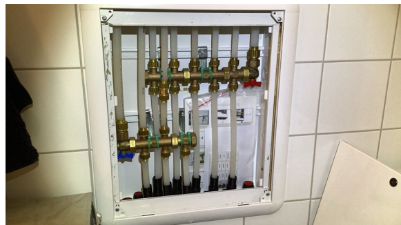
Fordelersskap på bad i 1. etasje.
