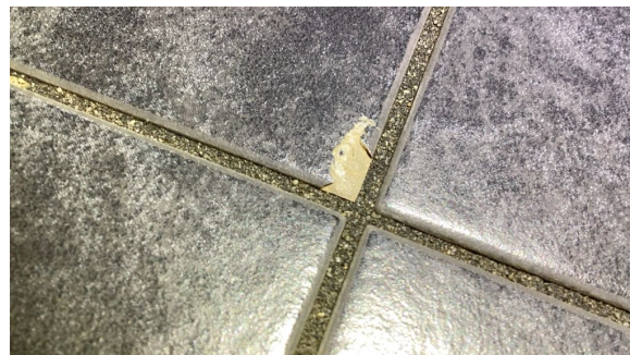
Avskalling på flis.
