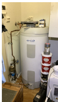
Varmtvannsbereider på teknisk rom/bod.
