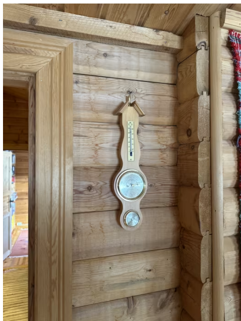
Det registreres fuktskjolder på maskinlaft.
