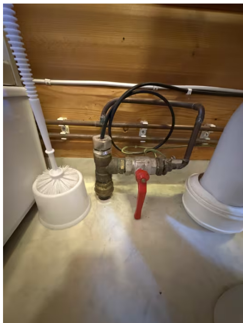
Viser vanninntak og hovedstoppekran plassert på bad.
