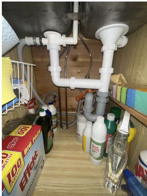
Viser vann og avløpsinnstallasjoner under kum.
