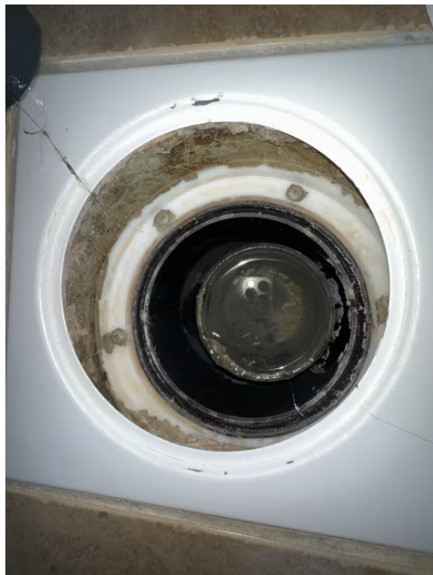
Viser sluk i dusjsonen.
