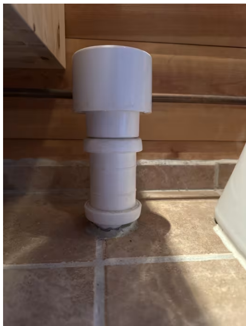
Lufting med vakumventil på bad.
