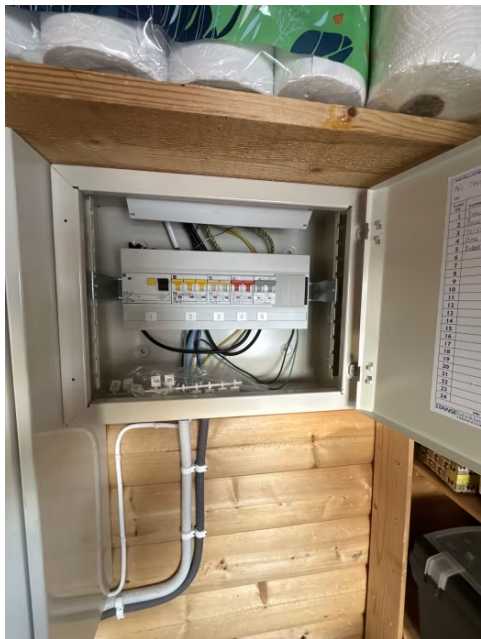
Viser sikringsskap plassert i utvendig bod.
