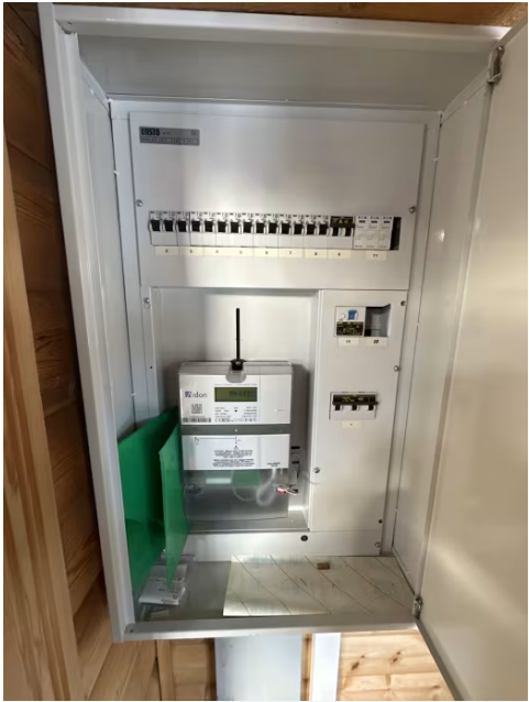
Viser sikringsskap plassert i utvendig bod.
