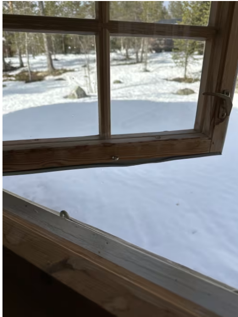
Vindu på kontor lot seg ikke stenge. Deformert tetteliste.
