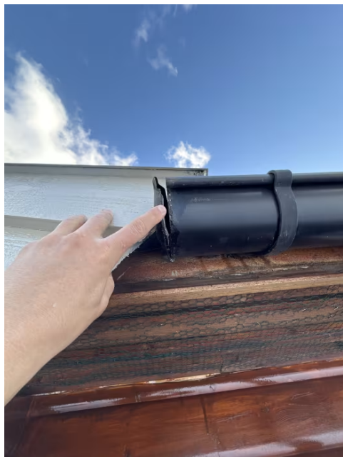
Takrenner har punktvisse lekkasjer.
