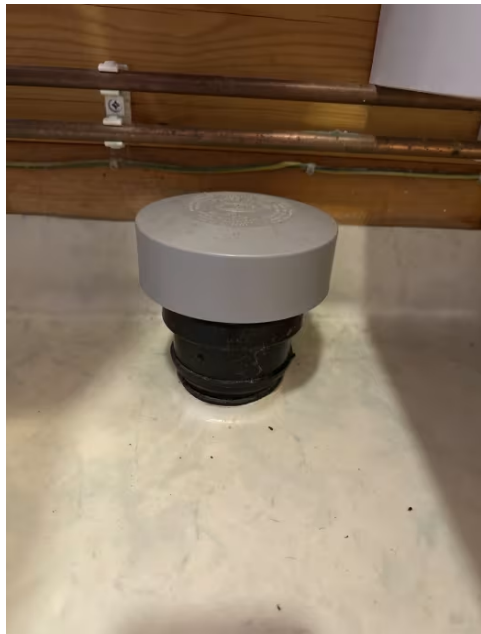
Lufting med vakumventil på bad.
