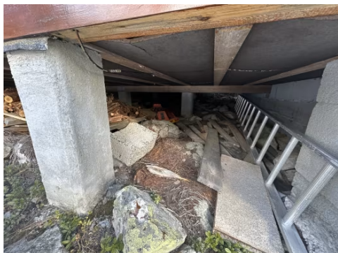
Det er påvist noen stubbloftsplater med utettheter.
