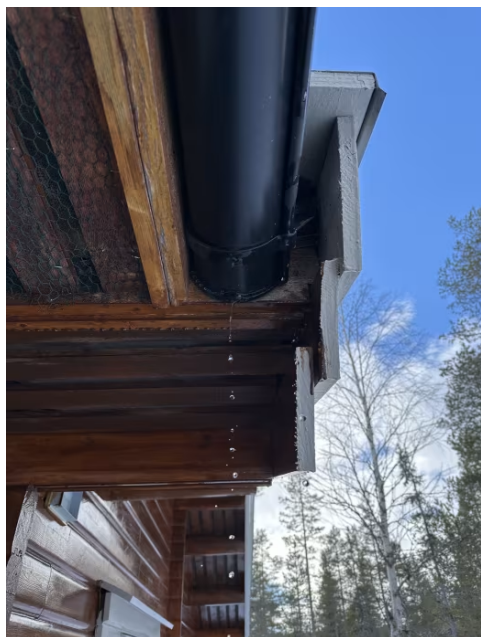
Takrenner har punktvisse lekkasjer.
