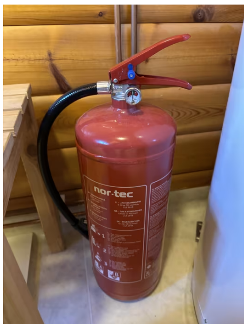
Brannslukningsapparat eldre en 10 år.
