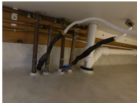
Kabler kommer opp ved vannrør på bad. Ukjent funksjon.
