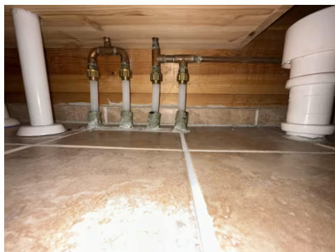
Lite oppbrett på rørføring gjennom gulv på vakuumventil.
