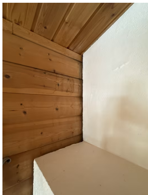
Viser fuktskjolder på vegg ved pipe. Tørt på befaringen. Opplyst eldre forhold.
