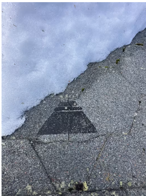
Lokale utbedringer ved tekkingen må påregnes. Knekt pappshingel.
