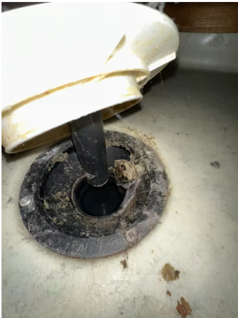
Viser sluk under dusjkabinett.
