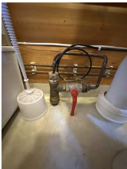
Viser vanninntak og hovedstoppekran plassert på bad.
