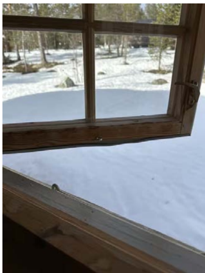
Vindu på kontor lot seg ikke stenge. Deformert tettelist.
