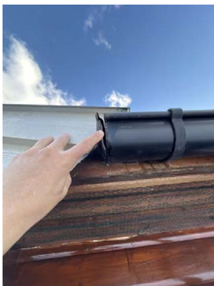
Takrenner har punktvis lekkasjer.
