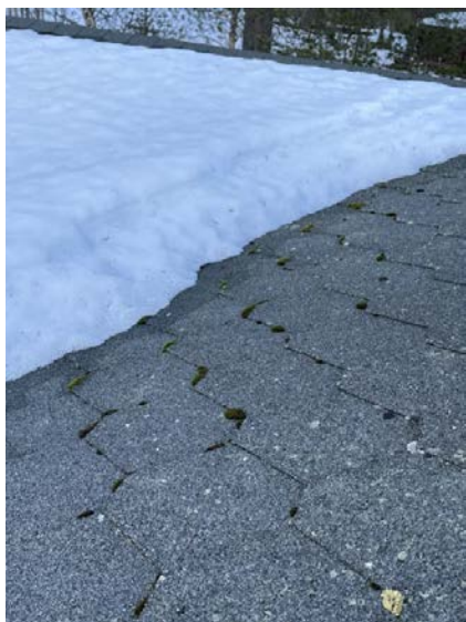
Det registreres stedvis noe mose på taket som anbefales fjernet som et vedlikeholdstiltak.
