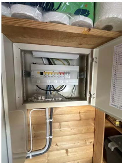
Viser sikringsskap plassert i utvendig bod.
