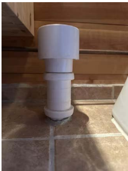
Lufting med vakumventil på bad.
