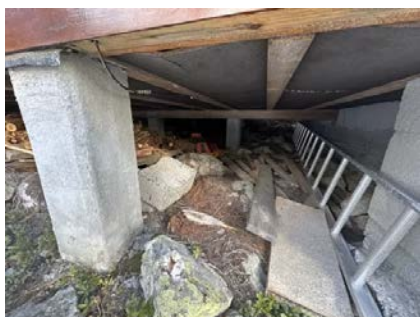
Det er påvist noen stubbloftsplater med utettheter.
