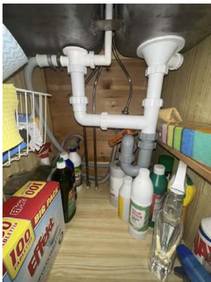
Viser vann og avløpsinnstallasjoner under kum.
