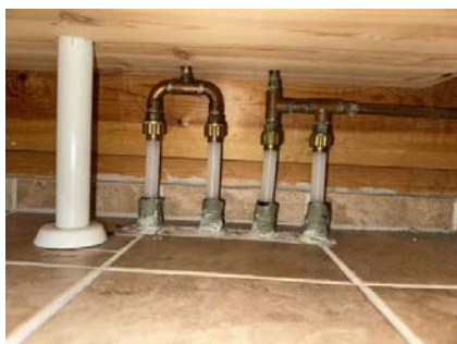
Viser rør i rør på bad i tilbygg.
