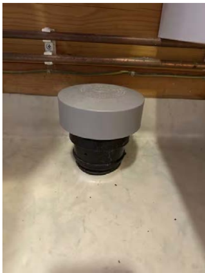
Lufting med vakumventil på bad.
