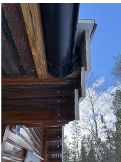
Takrenner har punktvis lekkasjer.
