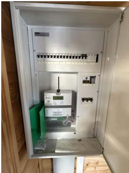
Viser sikringsskap plassert i utvendig bod.
