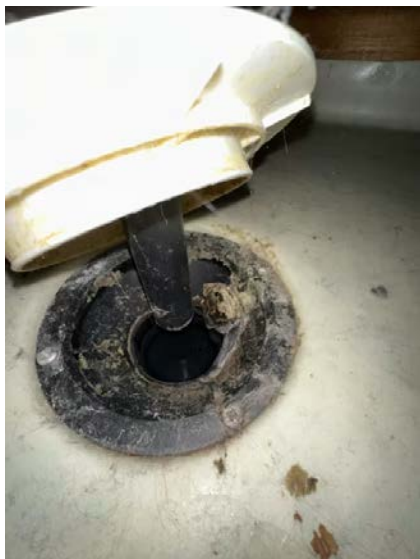
Viser sluk under dusjkabinett.
