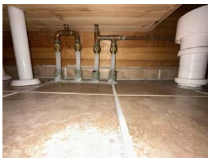
Lite oppbrett på rørføring gjennom gulv på vakuumventil.
