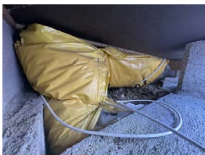
Del av krypkjeller uten etablert adkomst pga isolasjonsmatte.
