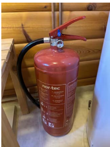
Brannslukningsapparat eldre en 10 år.
