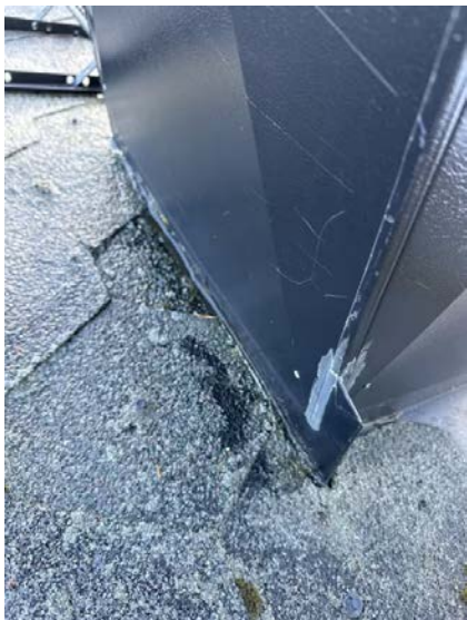
Det ligger vann mot beslag og det registreres fuktskjolder ved ildsted. Anbefaler ytterligere undersøkelser.
