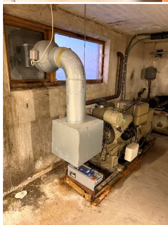
Eldre aggregat og kompressor
