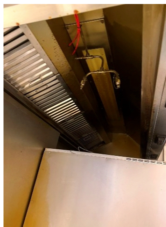
Slukkeanlegg over komfyrplass med avtrekk
