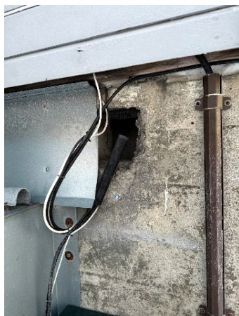
Hull i vegg som ikke er tett
