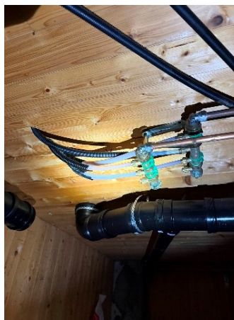
Rør i rør på vannledninger og plast avløpsrør
