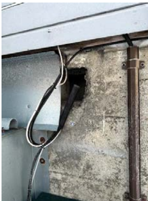
Hull i vegg som ikke er tettet
