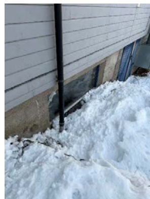
Vindu er nært bakken
