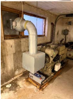
Eldre aggregat og kompressor
