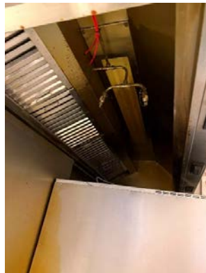
Slukkeanlegg over komfyrplass med avtrekk
