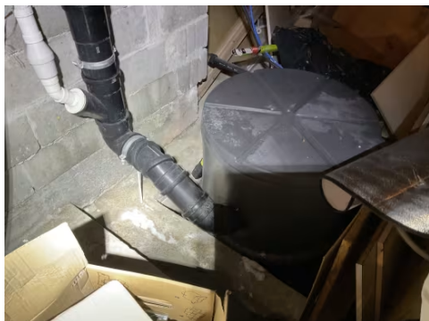
Avløp går til innvendig tank i plast.
