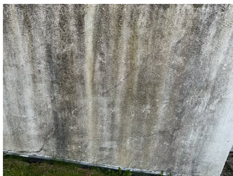
Sprekker i pussede flater.
