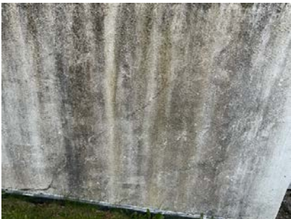
Sprekker i pussede flater.
