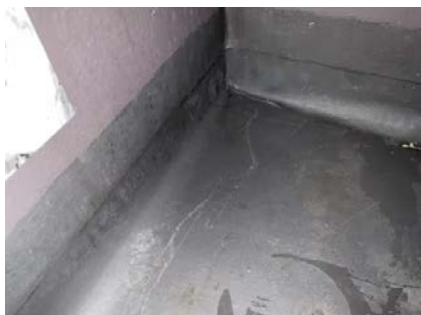
Sprekker på belegg/membran TG 3.
